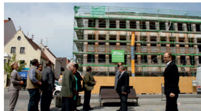
Im Rahmen einer Bau- und Vergabeausschusssitzung wurde bei einer Ortsbesichtigung über den aktuellen Stand der Sanierungsmaßnahmen beim Landratsamtsgebäude informiert. ■
